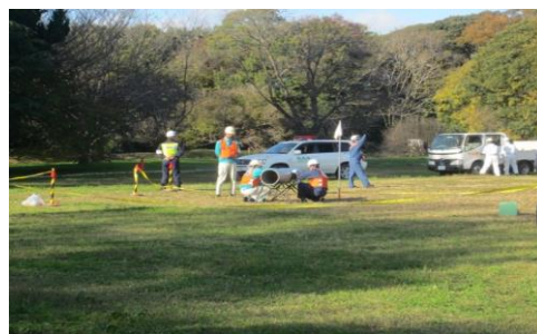
【巡回監視班応急対応】
